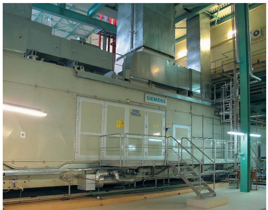
Газотурбинный энергоблок в звукоизолированном контейнере
