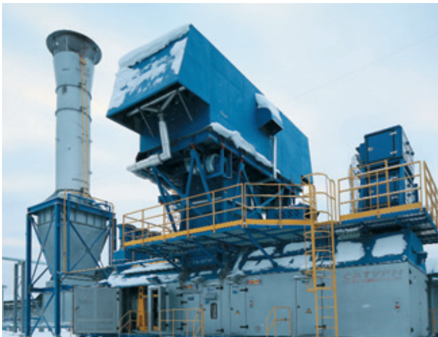
Газотурбинный энергоблок ГТА-6РМ установлен на открытой площадке
