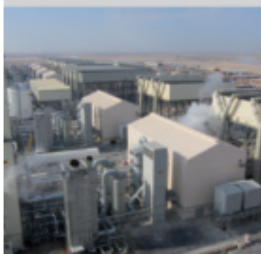
Системы шумоглушения для электростанции GTL-Anlage, (Пегла Катар), Linde AG
