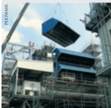
КВОУ ГТЭС, Filter-house Upgrade to HEPA Filtration, Заказчик ГТЭС - BASF, Людвигсхафен, Германия
