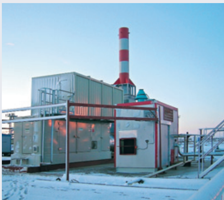
Энергоблок OPRA DTG-18/2GL
