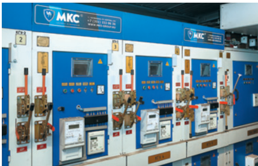
↻ Блочное комплектное распределительное устройство 6 кВ
