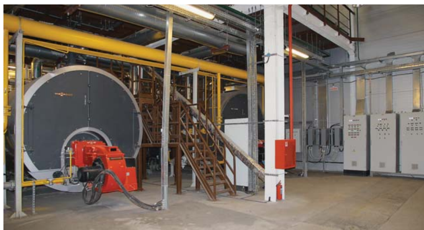
☪ Водогрейные котлы Vitomax-200HW мощностью по 8 МВт
