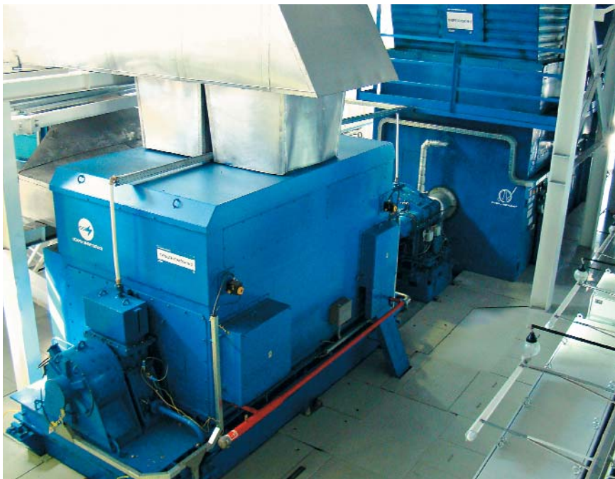
Силовой блок ЗГЭС-16
