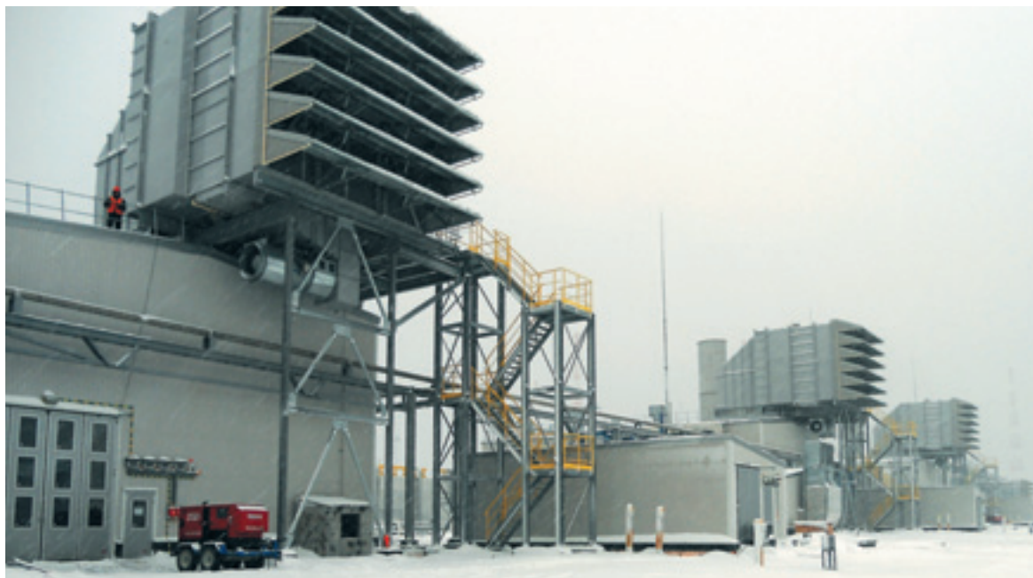
С Фото. Импульсное КВОУ с самоочищающимися фильтрами AAF ASC для ГТУ Trent 60 мощностью 50 МВт (Rolls-Royce). Компрессорная станция «Портовая» магистрального газопровода «Северный поток»
