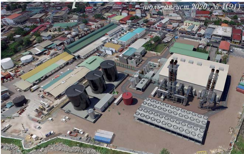
Фото на обложке: газопоршневая электростанция в г. Парамарибо, Суринам, на базе 6 энергоблоков 18V48 производства компании MAN
