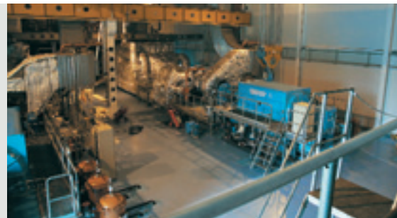
Когенерационная электростанция в Тамбове работает в базовом режиме и синхронизирована с энергосистемой
