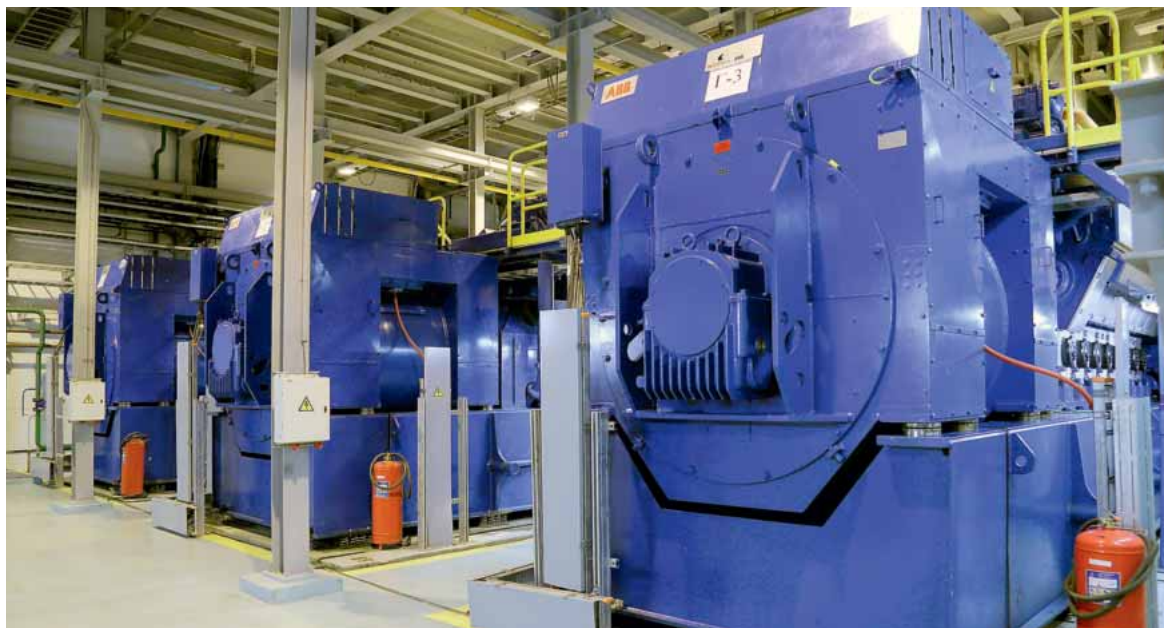
☞ Газопоршневые установки Wartsila 16V34SG
