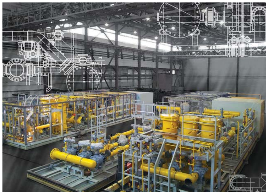
Фото 1. Производственная площадка ГК «Энергаз» в Белгороде
