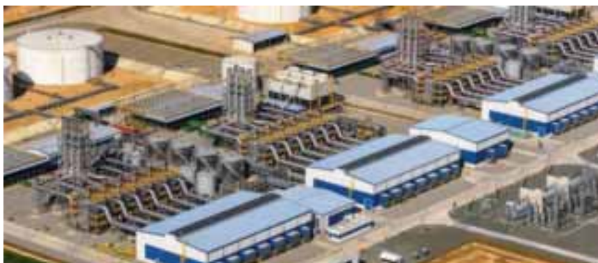
С Электростанция комбинированного цикла Quisqueya на базе энергоблоков Wärtsilä общей мощностью 430 МВт вырабатывает электроэнергию для нужд месторождения и национальной энергосети в Доминиканской Республике
