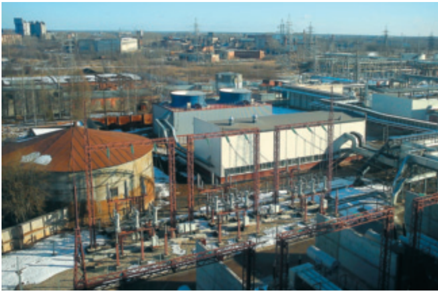
Открытое распределительное устройство (ОРУ-110)
