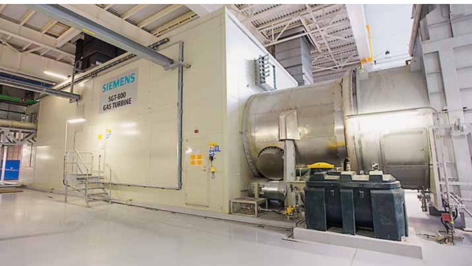
Газотурбинная установка SGT-800 в теплозвукоизолированном кожухе на ТЭЦ «Центральная»
