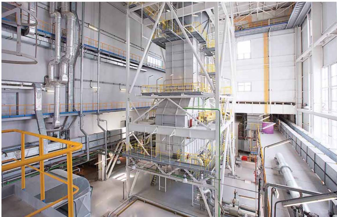
С Водогрейный котел-утилизатор КУВ-69,5/170
