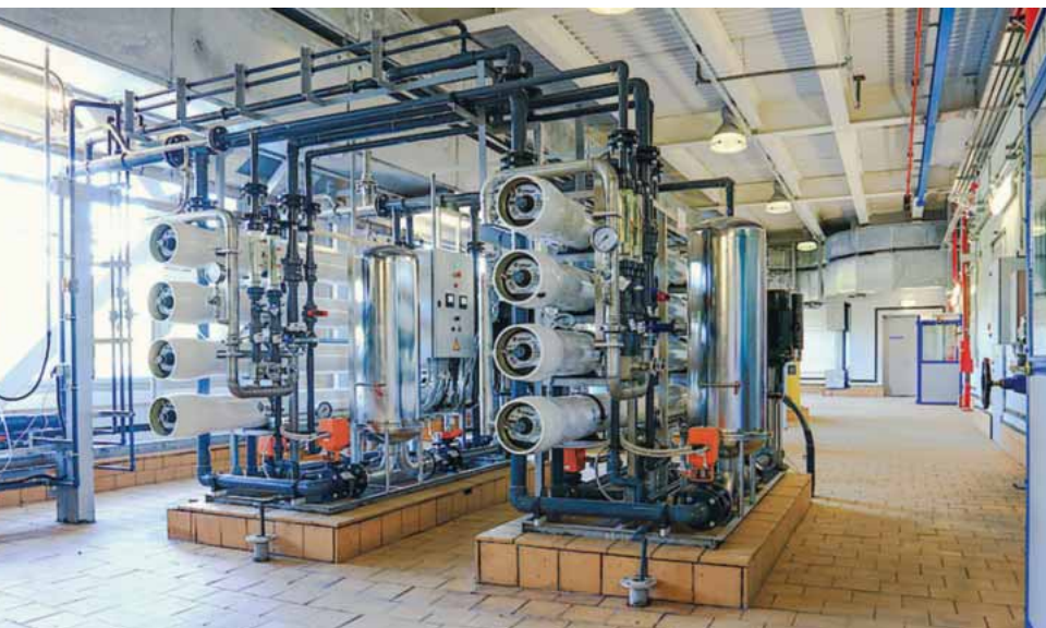
↻ Установка обратного осмоса
